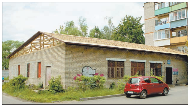
Новая кровля решит проблему протечек.
